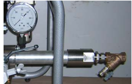
Dettaglio uscita pompa
